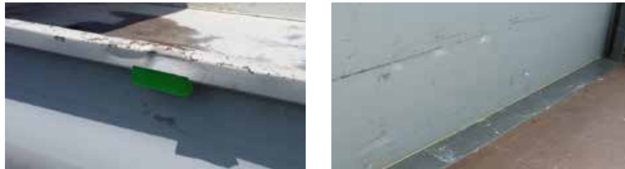
Leichte Kratzer, Schienenverformungen mit Reparaturzeit \leq 1 h
