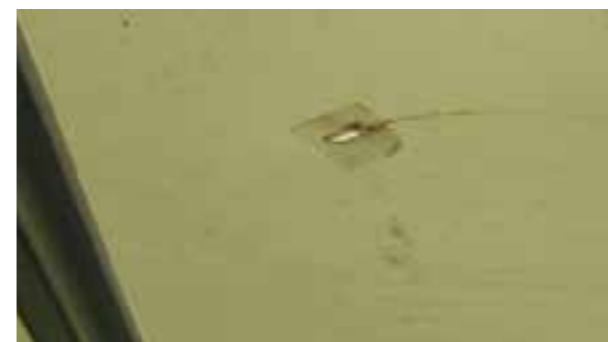
🔧 Dachfläche: Durchstoßen oder gerissen, kann auf wirtschaftliche Weise repariert werden
