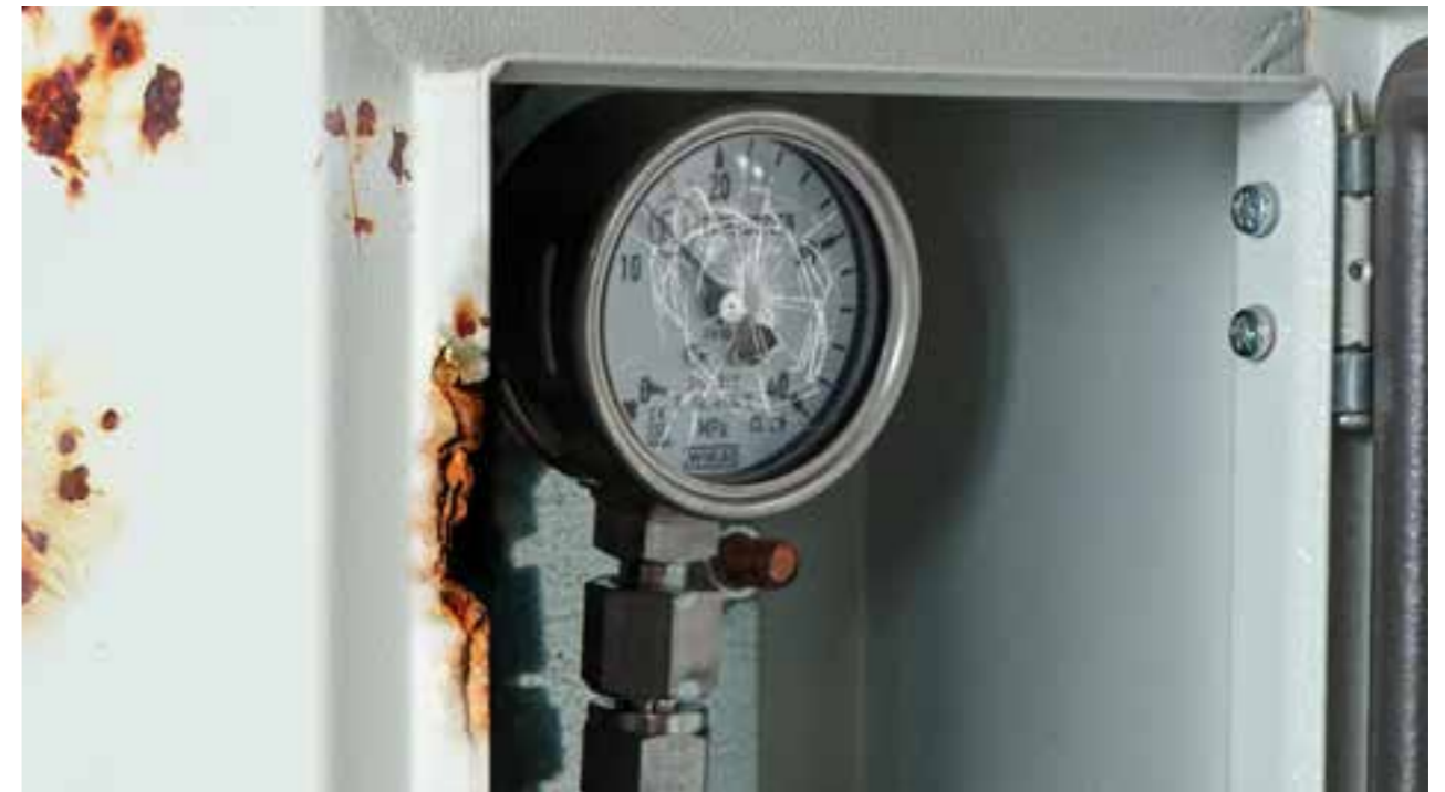
Fehlender Schutzkastenschlüssel, CNG-Stutzen oder Druckmesser beschädigt → Berechnung des Austauschs des gesamten Kastens.
