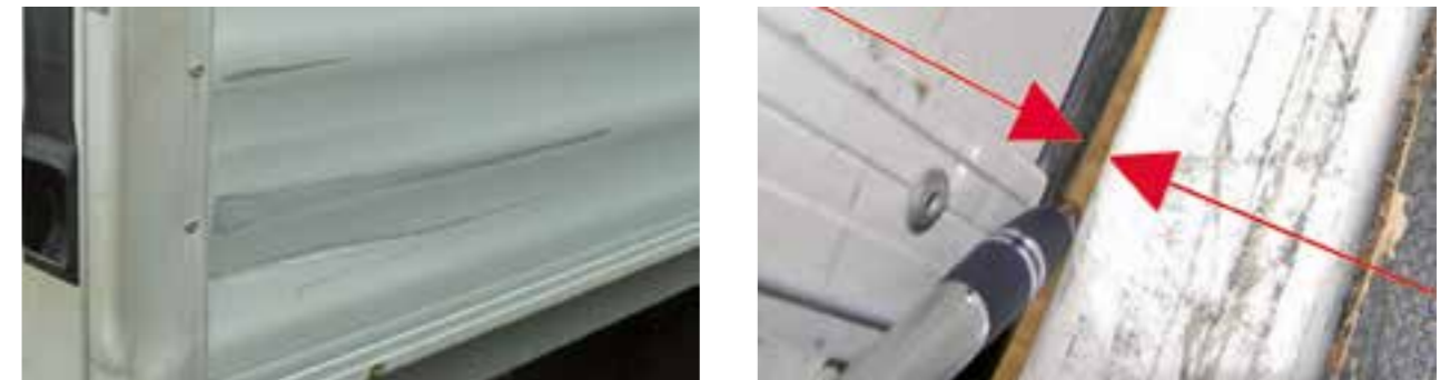
Verformungen in den Schienen, die auf wirtschaftliche Weise repariert werden können, Schließung nicht möglich oder nicht sanddicht
